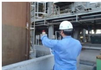
薬品タンクの確認
