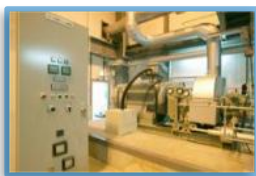
1号炉発電機 発電能力: 350kW
