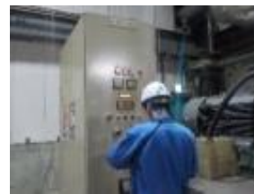
発電設備の点検
