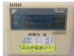
エアコンの温度管理
