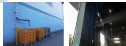
雨水貯留タンク 散水設備の活用
